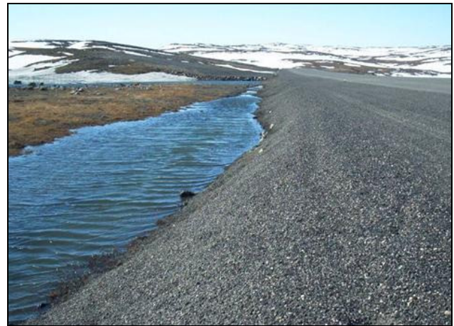
Figure 4. Perturbation du système de drainage de la piste d'atterrissage de Salluit
