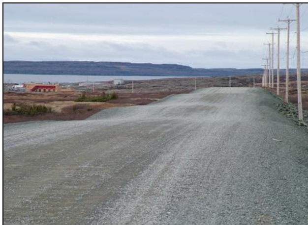
Figure 3. Tassements sur toute la largeur de la route d'accès d'Umiujaq
