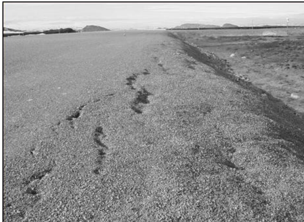
Figure 2. Tassements en bordure du remblai de la piste d'atterrissage de Tasiujaq
